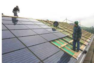
Toiture : panneaux photovoltaïques intégrés
